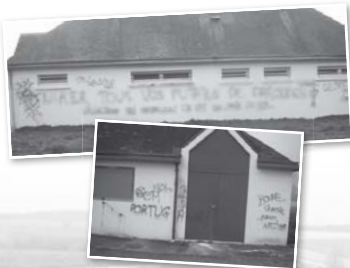
Avant rénovation de peinture
